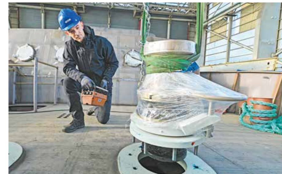
KRAFTPAKET: Da das Schiff jeweils einen Anker auf der Steuerbord- und der Backbordseite hat, gibt es zwei vertikale Winden. Eine davon wird hier gerade von Albert Kabashi montiert.
