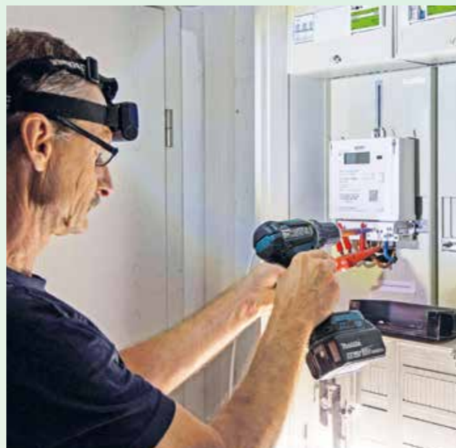
SMARTER KASTEN: Der digitale Stromzähler ermittelt den Verbrauch und überträgt laufend die Daten an den Stromversorger.
